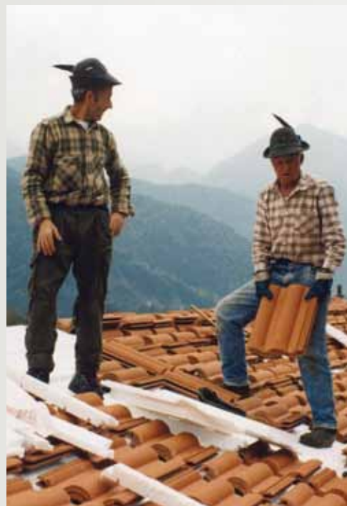
Lëtu 1997 - Dila za naredit to nöwo sede alpinuw. Anno 1997 - Lavori durante la costruzione della nuova sede del gruppo.
